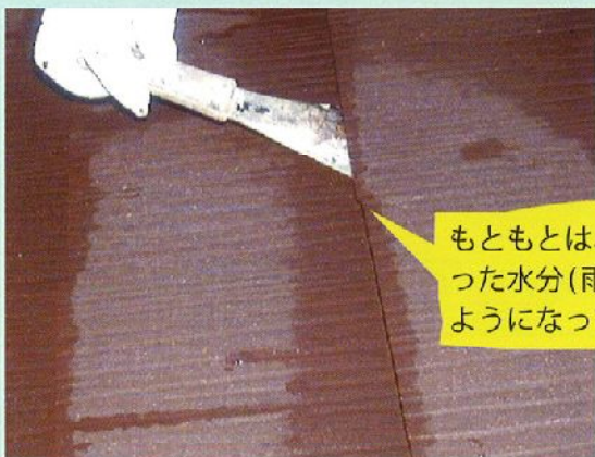
● 塗装前、雨上がり2時間後の様子
